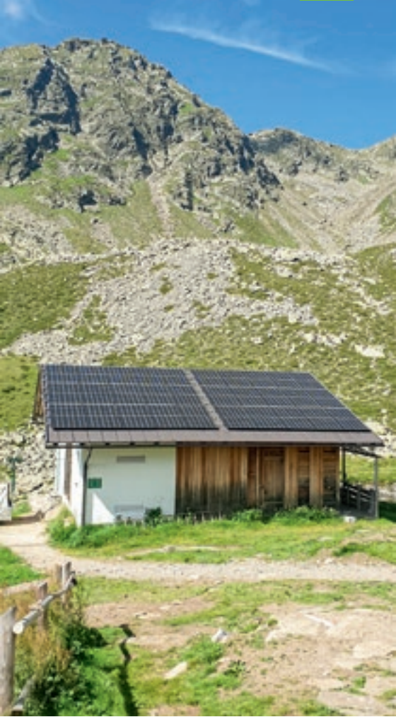
Am Dach der Bergstation der Tiefrastenhütte wurde 2024 eine Photovoltaikanlage installiert
